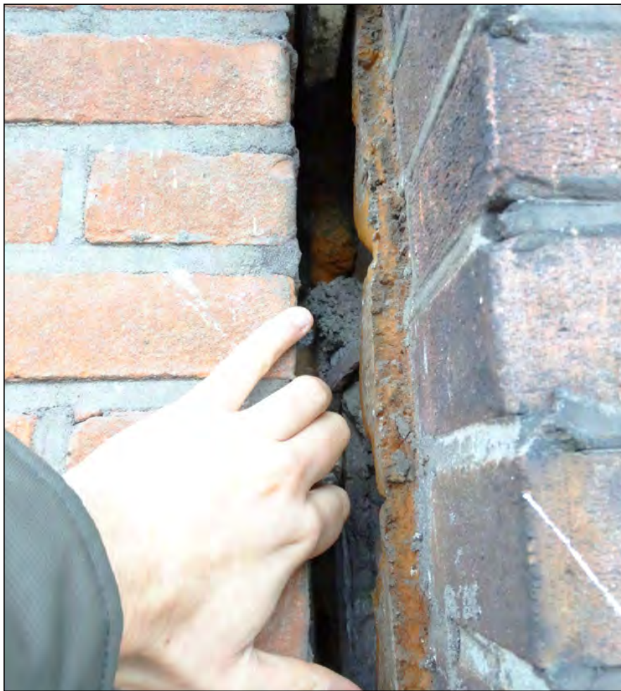
Figuur: tussen de woning en de aanbouw zit een forse spleet waardoor de spouwmuur zichtbaar is.
