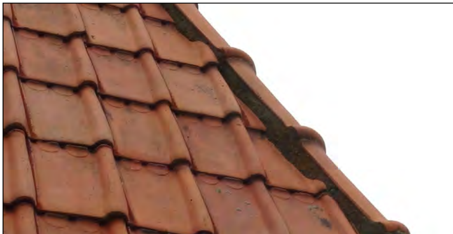
Figuur: de dakpannen zijn ongeschikt voor vogels en vleermuizen om onder te kruipen. De nokvorsten zijn dicht gemetseld, waardoor niets er tussen kan kruipen.
