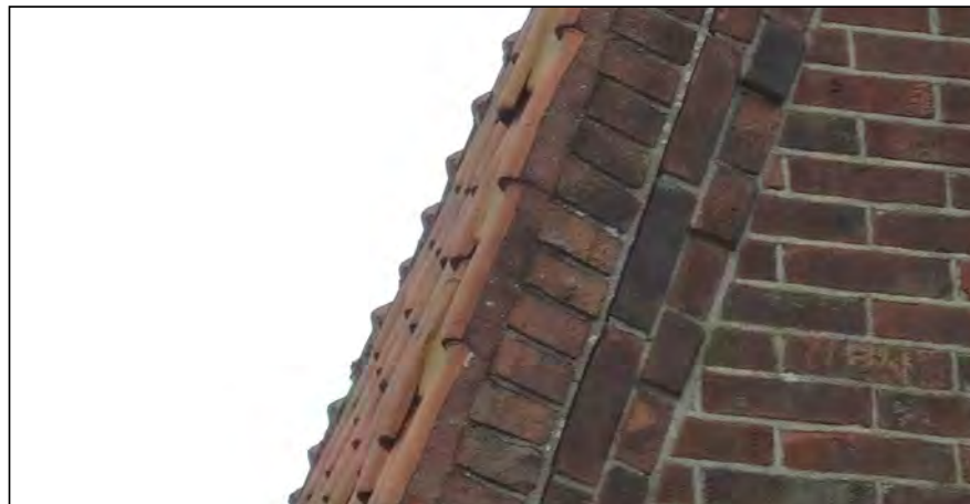
Figuur: ook de gevelpannen zijn dichtgemetseld, waardoor er geen ruimten zijn voor vleermuizen om in te kruipen.
