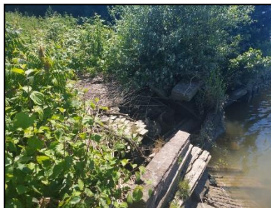
Figuur 2-6 Ingevallen steiger.
