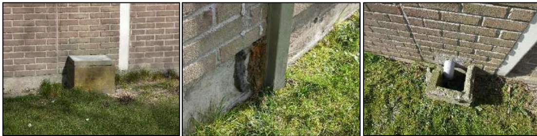
Figuur 11: Onderzijde regenpijp, op sommige plekken is de omhuizing weg of beschadigd en op een andere manier dicht gemaakt.
