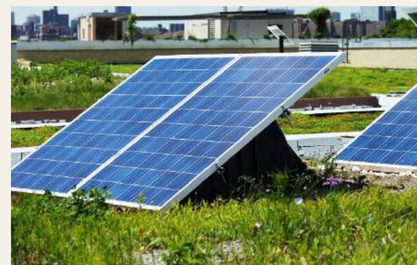
Zonnepanelen op sedumdak
