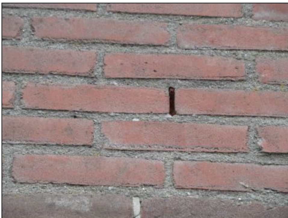
detail open stootvoeg, ze zijn voor vleermuizen te smal
