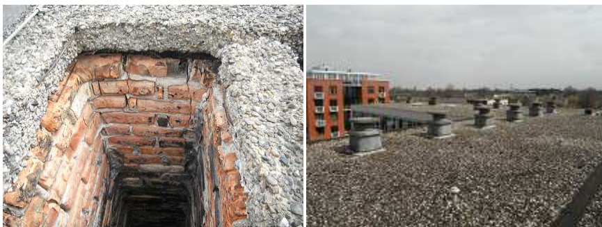
Schacht van schoorsteen (links). Overzicht ventilatie-structuren Bloemswaard.
