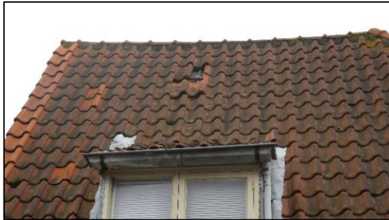
Foto 2: Gat tussen dakpannen
