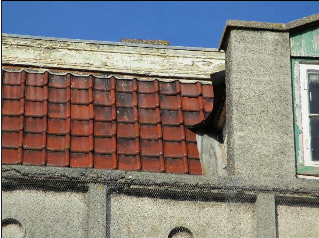
Figuur 3 Er is rondom en onder de dakpannen met gaas gewerkt, waardoor de onderste rij dakpannen ontoegankelijk zijn ten aanzien van huismus.
