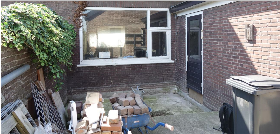
Figuur 11: De volledig versteende binnenplaats waar een uitbouw zal komen.
