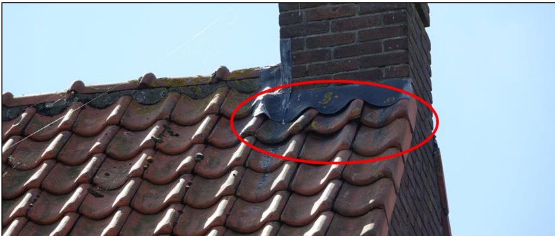
Figuur 9: Enkele losliggende dakpannen op het te verbouwen dak.
