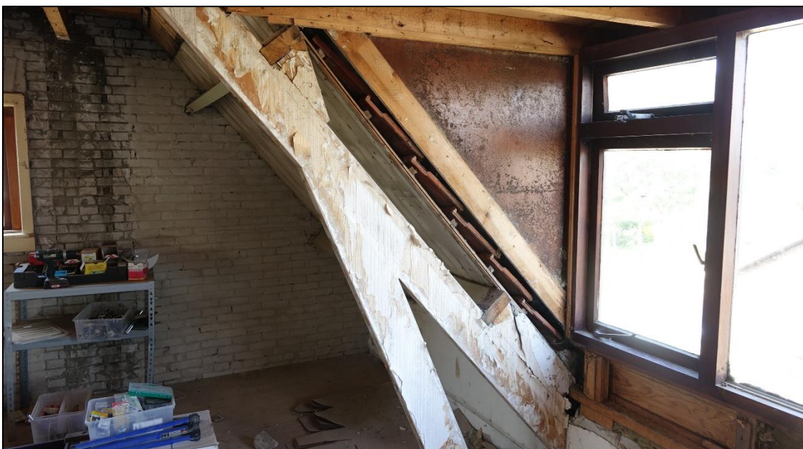
Figuur 10: Zicht op de dakpannen vanuit de binnenzijde waar sterkte tocht langs trekt.
