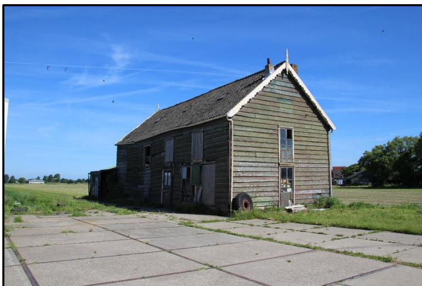
Afbeelding: de bestaande vervallen bollenschuur. Het bouwplan gaat uit van een reconstructie van de schuur met nieuwe aanbouw welke plaats zal bieden aan een woonhuis met bed&breakfast.
