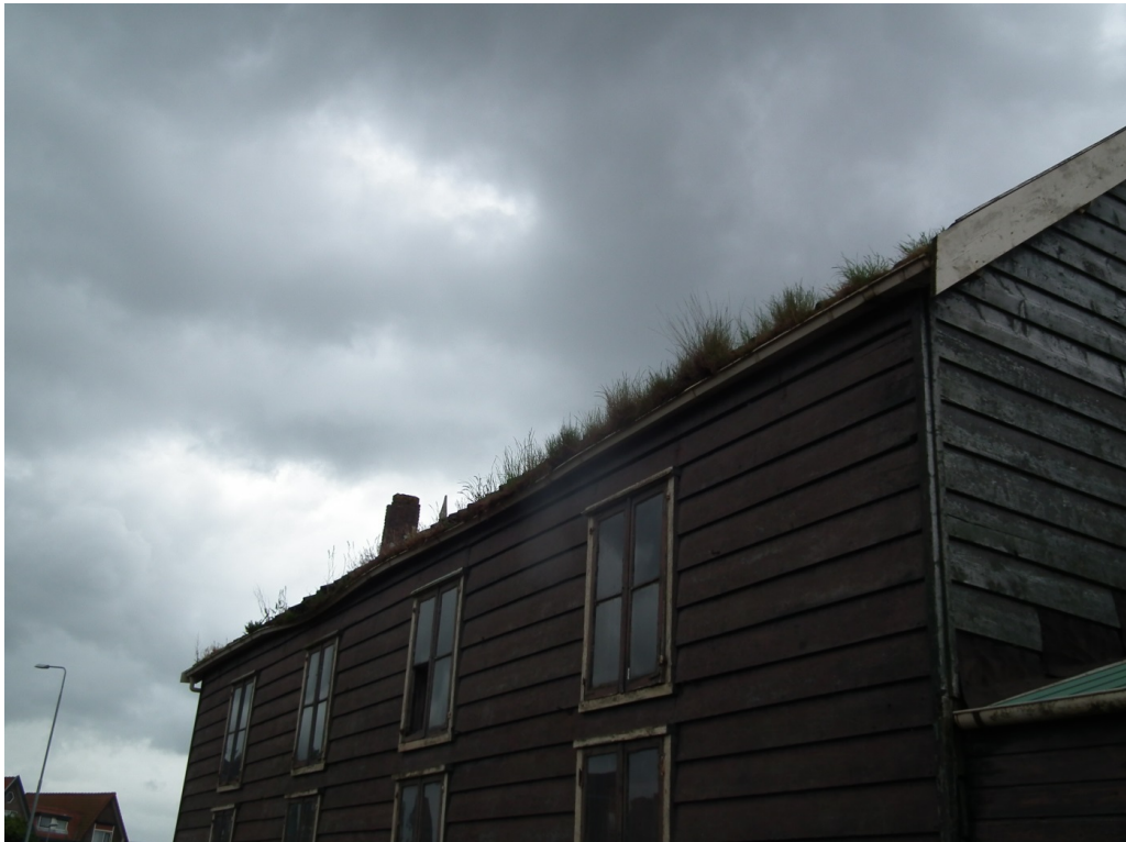
Figuur 4 De bollenschuur verkeert in een zeer slechte staat van onderhoud. De dakgoot is sterk begroeit, glas ontbreekt in de meeste ramen en er zijn zeer grote gaten in de muren en het dak.
