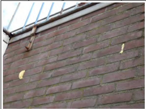
Foto 5 open stootvoegen dichtgemaakt met purschuim
