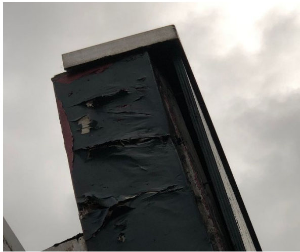
Figuur 11. Ruimte tussen spaanplaten bij dakrand
