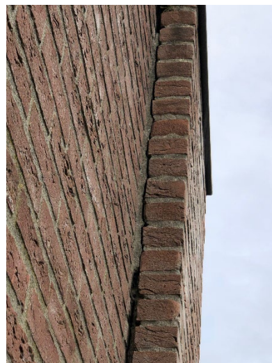
Figuur 9. Spleet tussen muren
