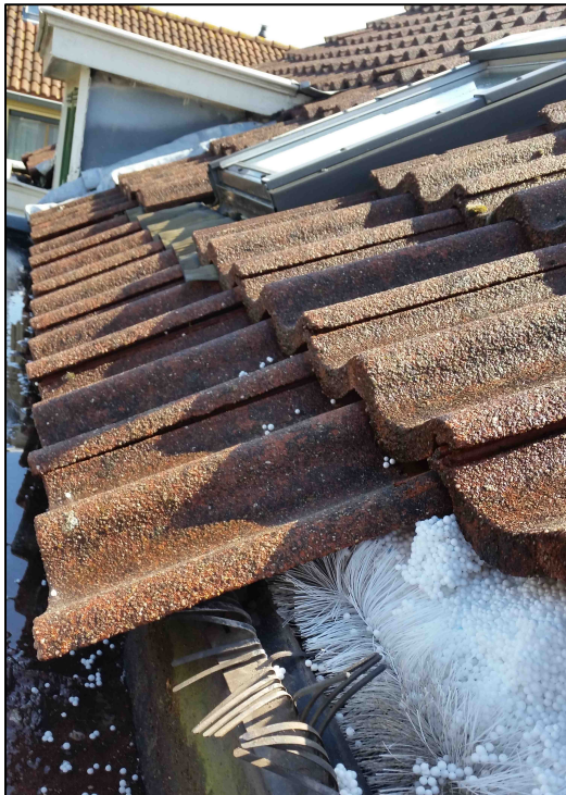
Afbeelding 1. Foto van het pannendak, met onderin beeld de plastic vogelschroot, daarachter een borstelwering en daarachter de piepschuim nisolatie direct onder de dakpannen.
