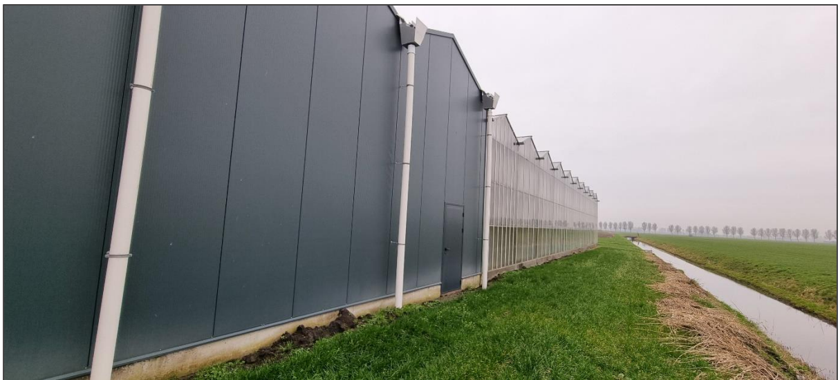
Afb 9: Sandwichpanelen ongeschikt voor vogels
