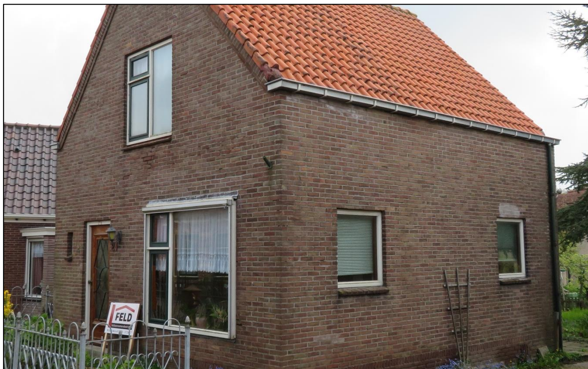
Afb 13: Open stootvoegen ontbreken
