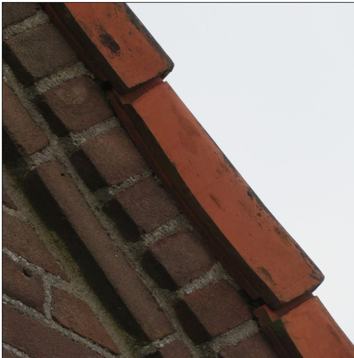
Afb 12 : Geen opening tussen gevelmetselwerk en kantpannen
