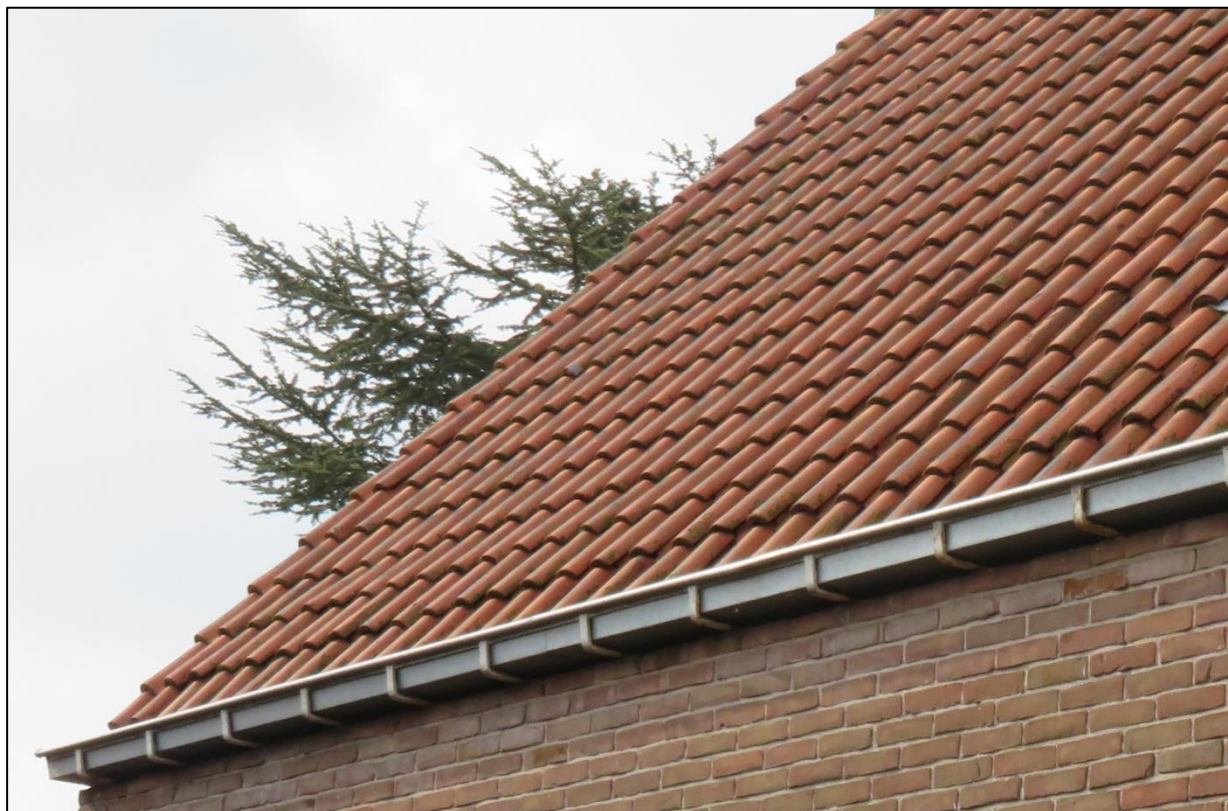
Afb 11: Vanuit de goot kunnen vogels onder de pannen komen. In het dakvlak ontbreken openingen
