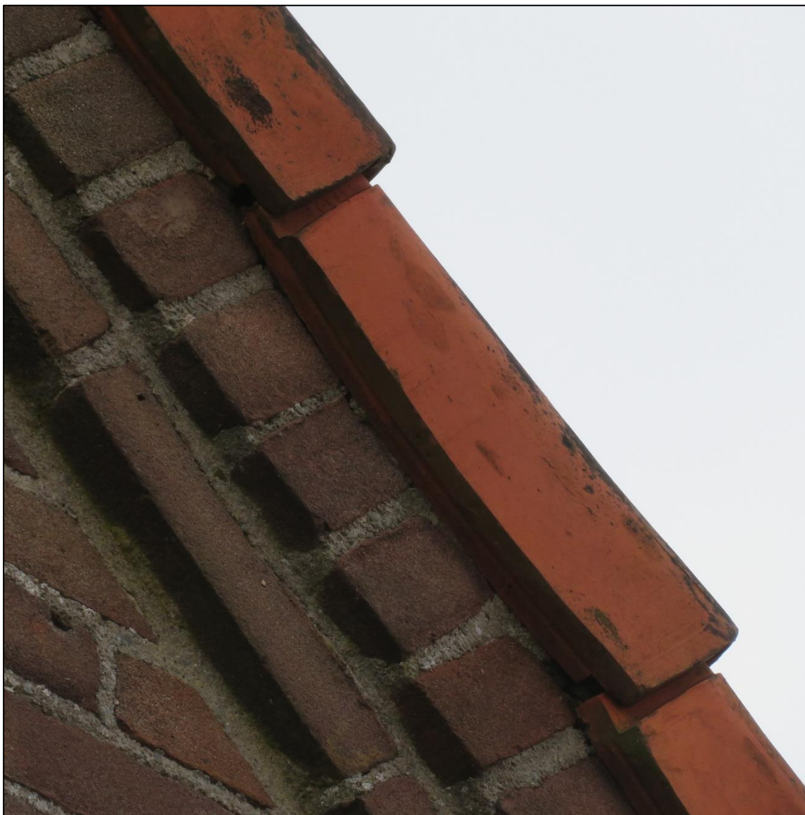
Afb 8 : Geen opening tussen gevelmetselwerk en kantpannen
