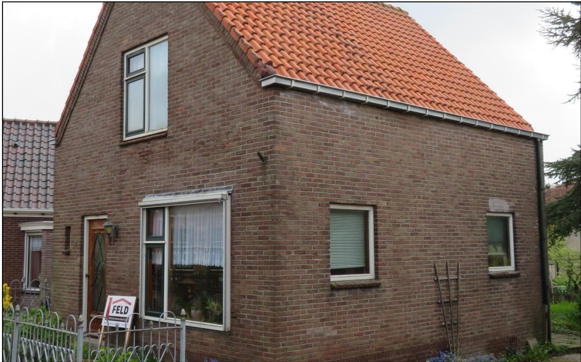
Afb 9: Open stootvoegen ontbreken
