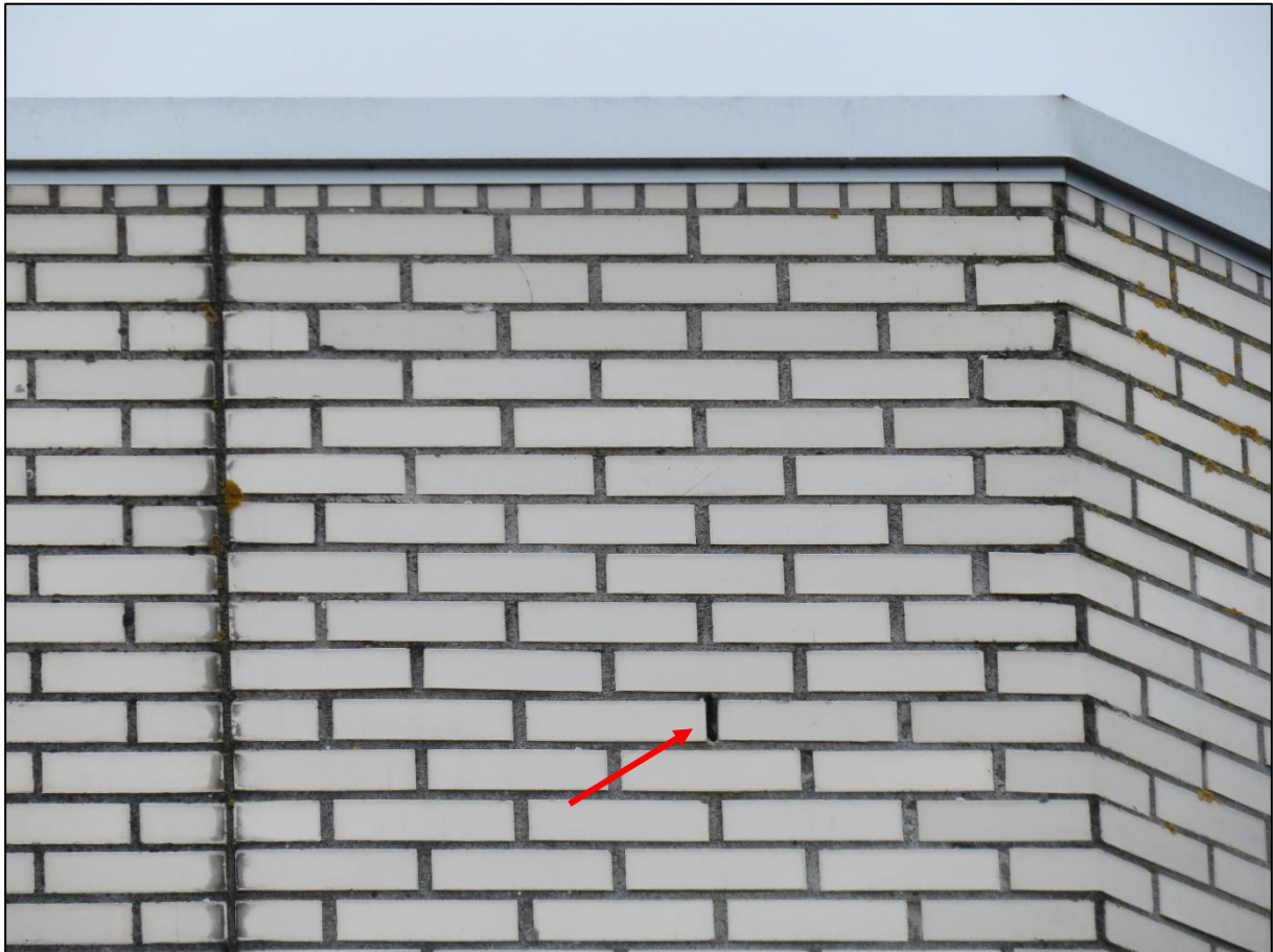
Afb 11: Eén van de meerdere open stootvoegen in de gevel
