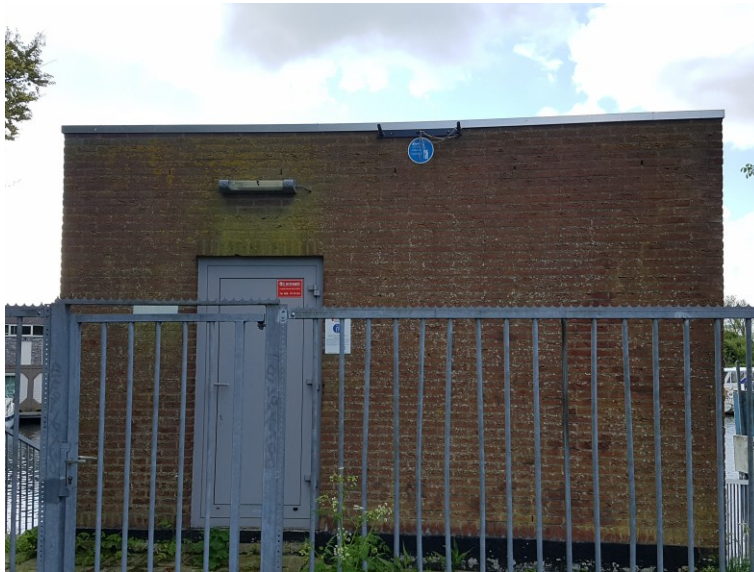
Afbeelding 8: Het trafohuisje in het zuidelijk deel van het plangebied. Open stootvoegen zijn aanwezig 2 dm onder de dakrand, boven de deur is verlichting aanwezig. Direct rondom het gebouw is hekwerk aanwezig met verticale spijlen en scherpe punten.
