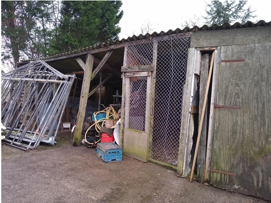
Foto 1: de half ingestorte schuur vormt een gevaar en is niet meer van deze tijd. Onderzoek heeft aangetoond dat de schuur niet gebruikt wordt door beschermde dieren en planten.
