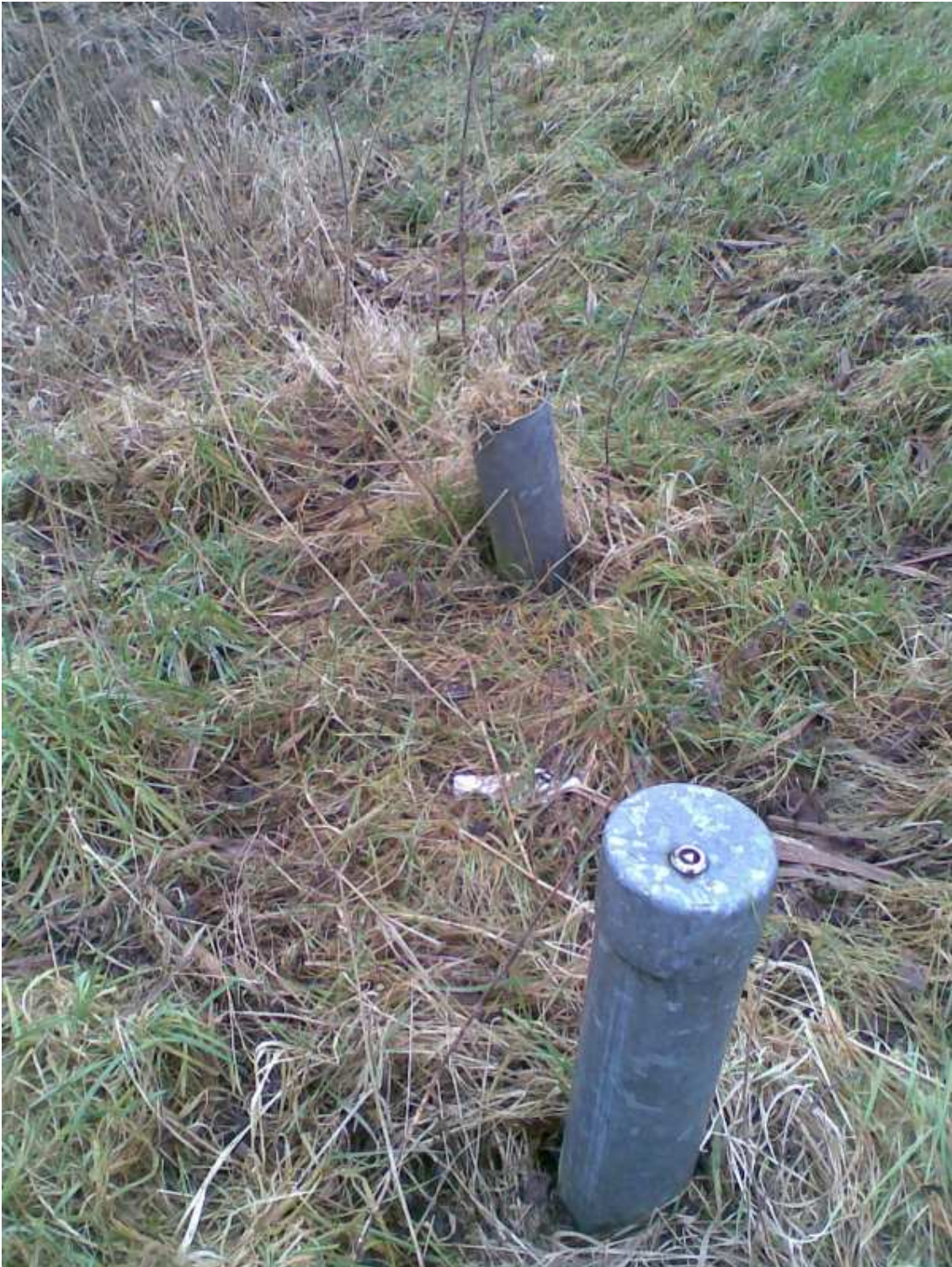
peilbuizen A1x en A1y (foto: GM 07 Pb01a).
