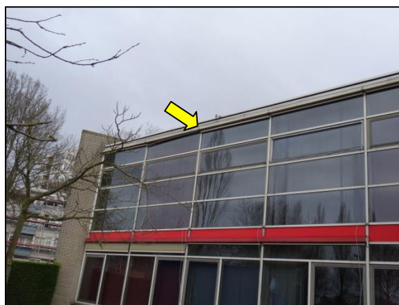
Figuur 11. Potentiële verblijfplaats voor vleermuizen.
