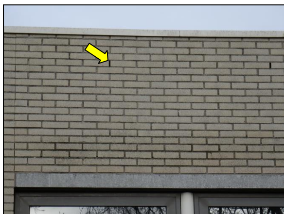
Figuur 10. Potentiële verblijfplaats voor vleermuizen.
