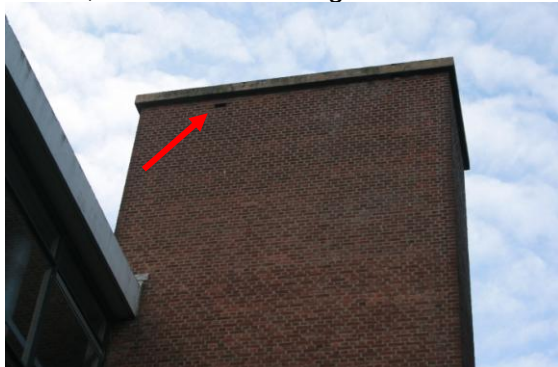
Foto 5, schoorsteen met gat
