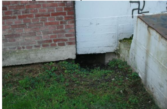
Foto 6, gat naar kruipruimte
