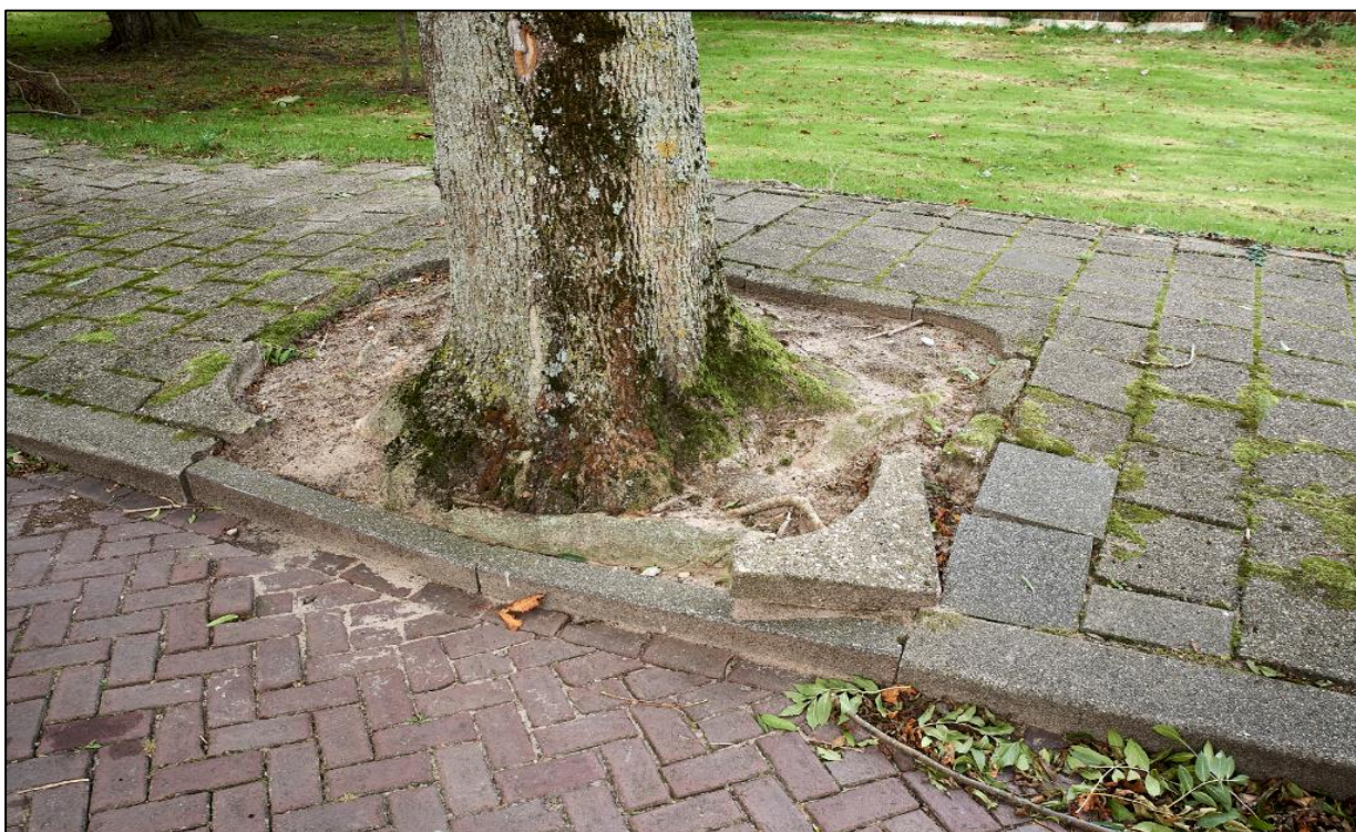
Foto 3: Voorbeeld van schade aan de verharding door wortelopdruk van een gewone es (DH206) aan het Veldzicht.
