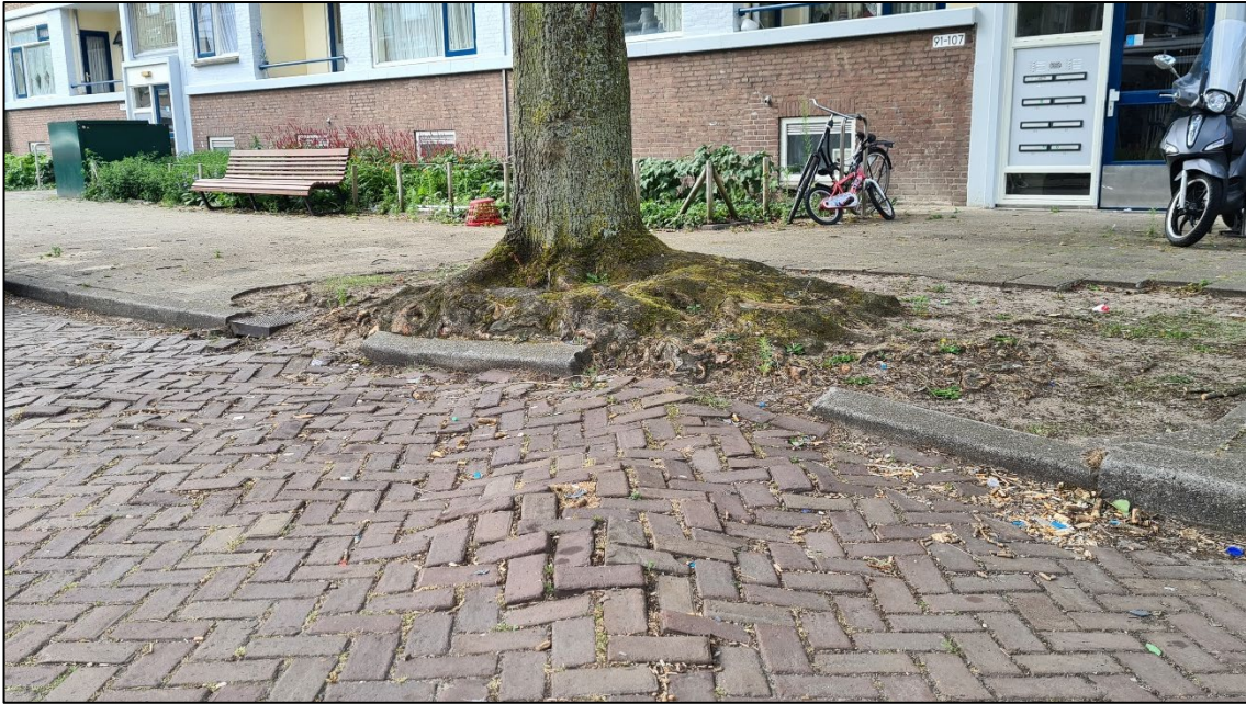
Afbeelding 5: Boom DH_124 heeft de opsluitbanden weggedrukt en drukt de verharding van de rijbaan op (De Dreef).
