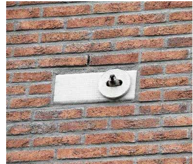
In de gevel geïntegreerde nestkasten
