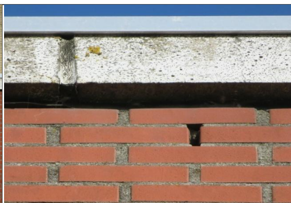
Foto 6 – de brede luchtspouw is alleen toegankelijk via open stootvoegen, niet via de dakrand (of dilatatievoegen).
