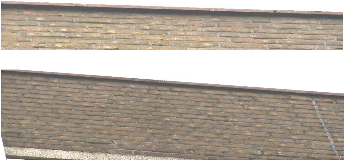
Figuur 9. Niet geschikte daklijsten doordat deze volledig zijn afgesloten.
