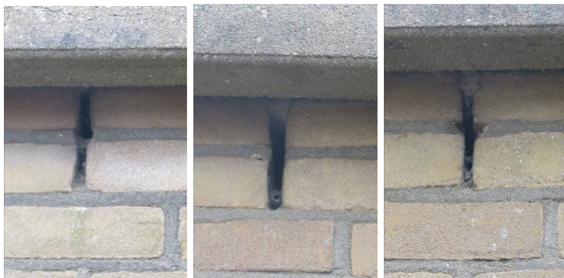
Figuur 7. Beeld van stootvoegen in het elektriciteitshuisje in het plangebied van Lozerhof te Den Haag.
