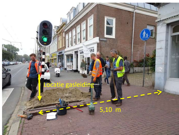
Locatie gasleiding bij huisnummer 7
