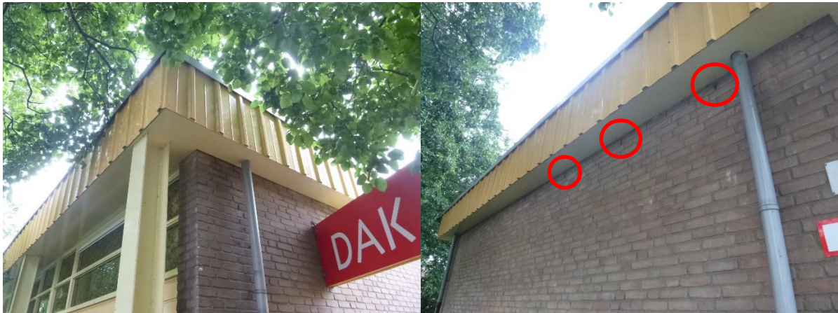
Figuur 3-1. Het schoolgebouw waarbij op de foto zichtbare open stootvoegen rood zijn omcirkeld.
