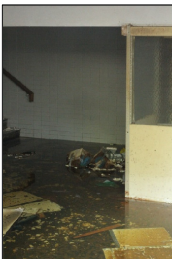
Foto 5: Kelder met water
