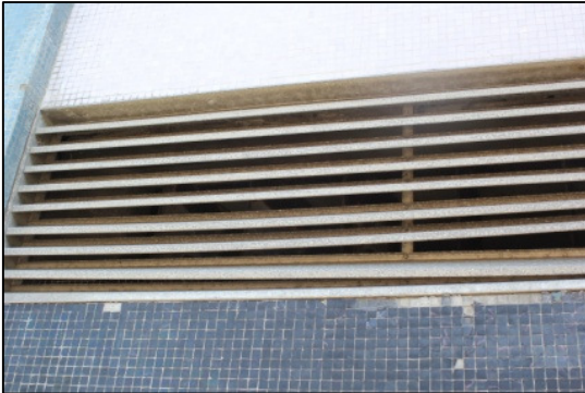
Foto 1: roosters mogelijke ingang voor vleermuizen
