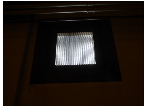
Foto 4: Roosters in het gebouw, belemmert toegang voor vogels/vleermuizen
