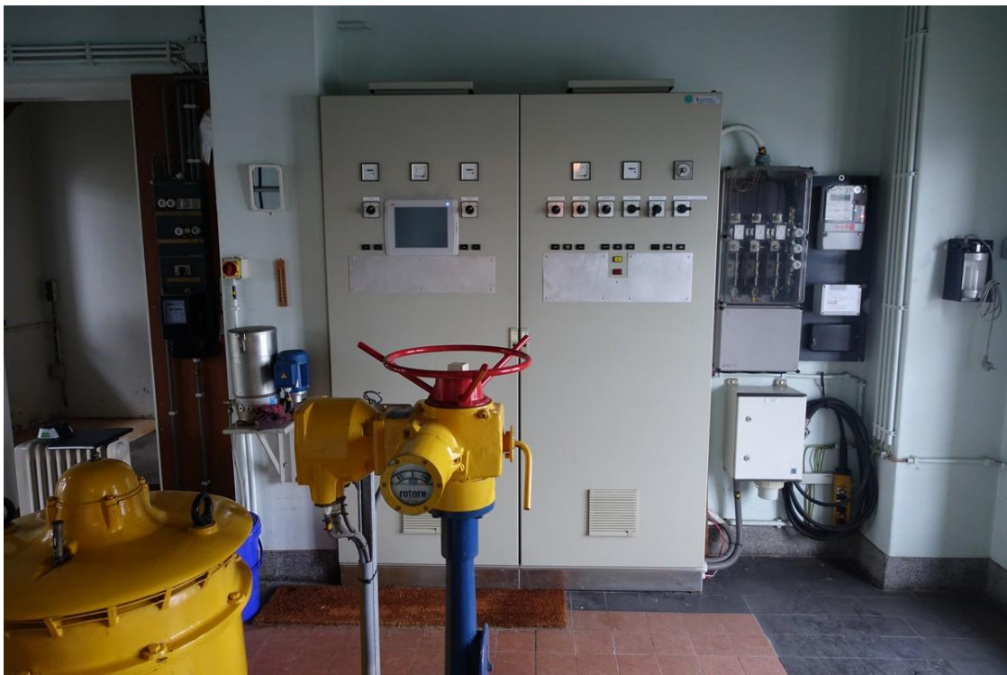
De schakelkasten die de pomp aansturen en rechts daarvan de zekeringen en de aansturing van de kraanbaan. Op de voorgrond de pomp en de afsluiter.
