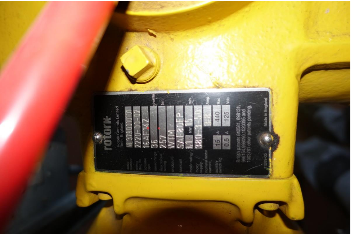
Het plaatje met de technische gegevens van de afsluiten van de firma ROTORK.
