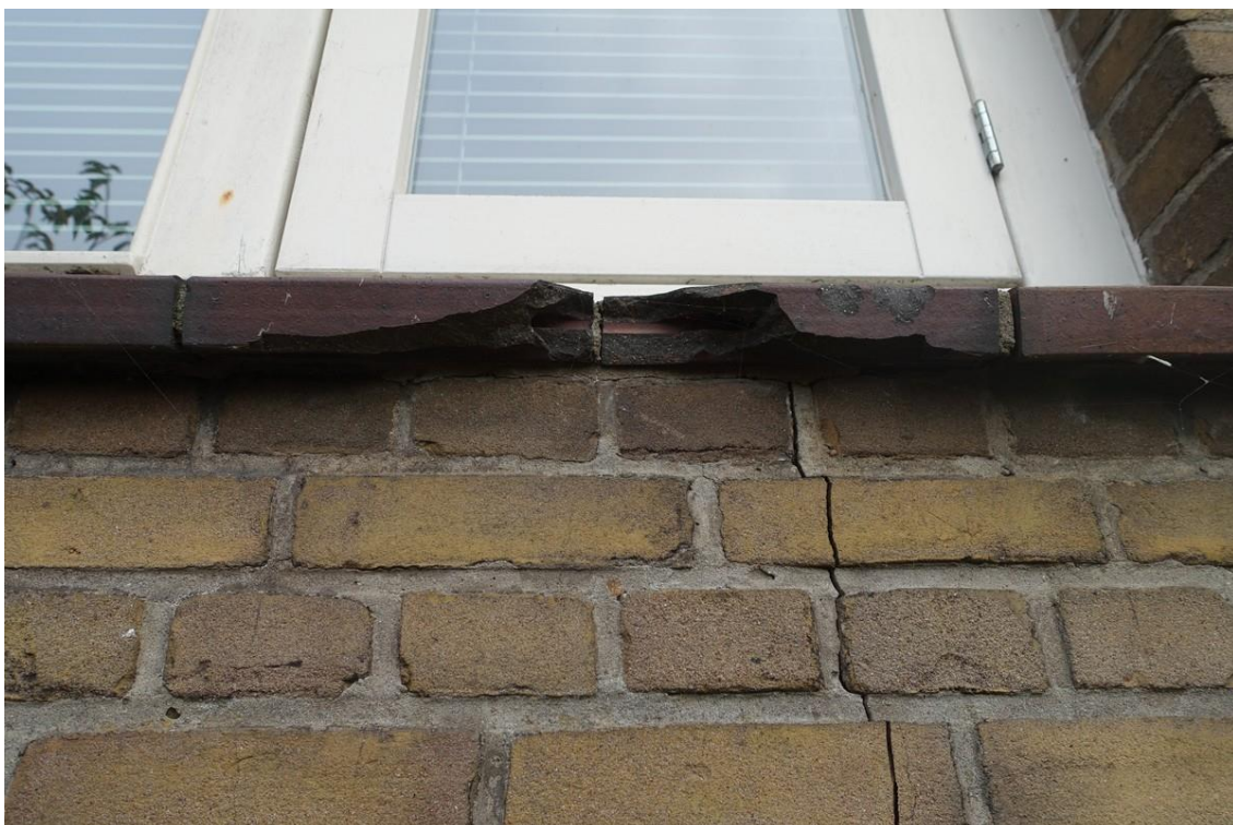
De raamdorpels onder het venster van de keuken. De gebroken dorpels laten de structuur van deze bouwkeramiek goed zien. Eronder het metselwerk met één van de vele scheuren. Erboven het vernieuwde raam in het oorspronkelijke kozijn.
