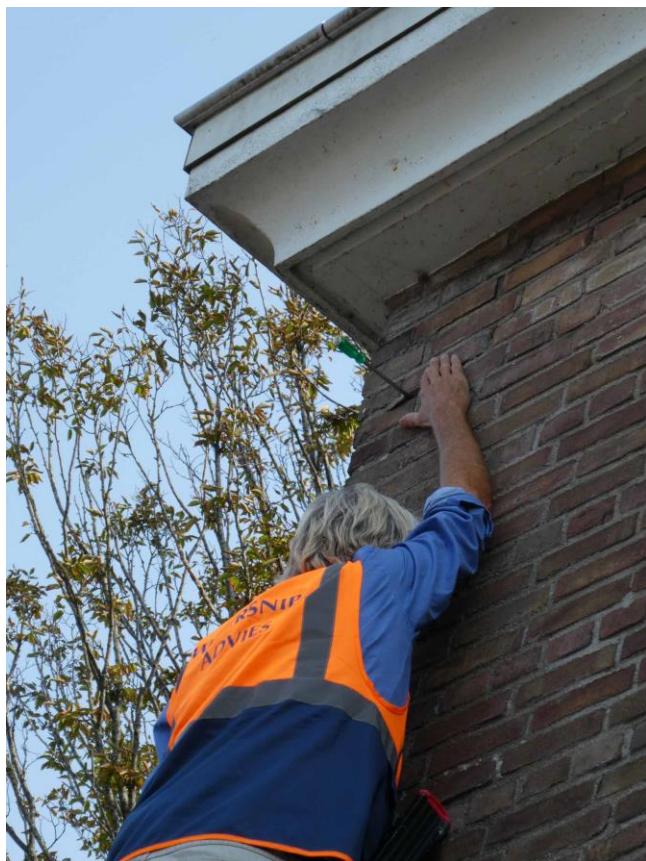
Figuur 11: Inspectie gaten aangegeven door IDDS. Zie schroevendraaier, staat in beschadigde, geërodeerde voeg
