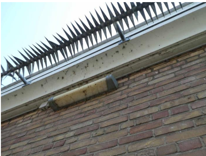
Figuur 8: Verlichting direct onder de dakrand
