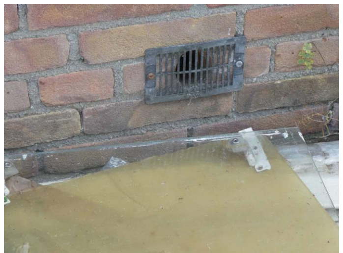
Figuur 9: Ventilatie-rooster onder in de muur
