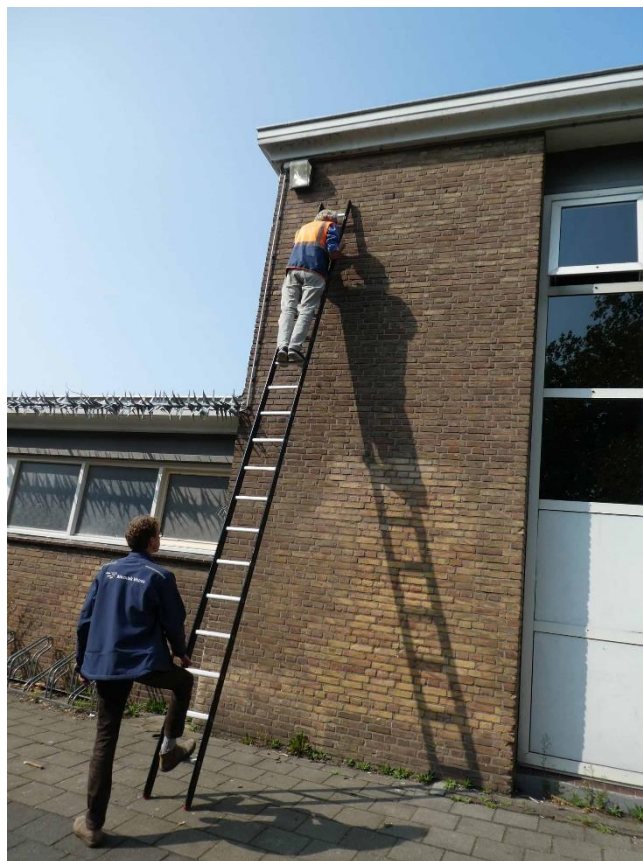
Figuur 12: Inspectie open stootvoegen nabij verlichting
