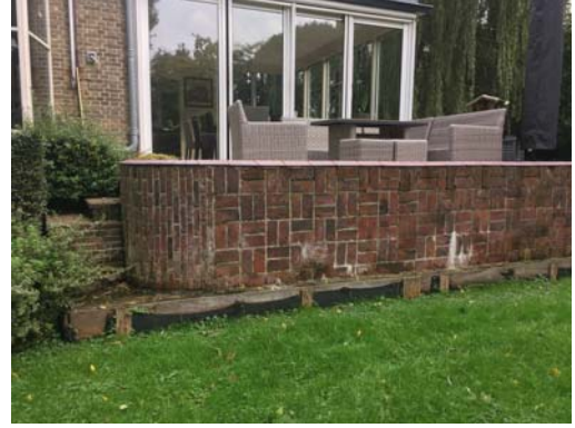
Foto 6: Fundering achterzijde woning met ingeklonken bodem
