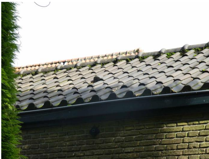
Figuur 13: Dichte dakpannen aan de voorkant van het dak
