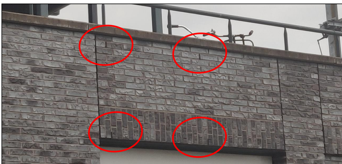
Figuur 8: Detailfoto van de open stootvoegen in de gevel van de fietsenstalling.
