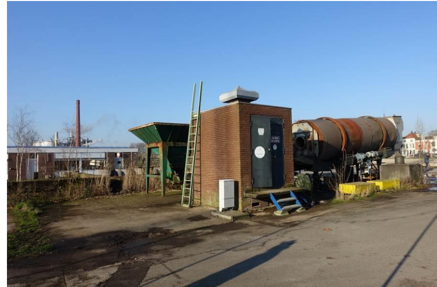
Trechters, trommel en trafohuis van asfaltinstallatie.
