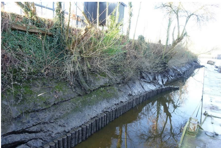
Steenachtige oeverafwerking ter hoogte van losplaats, maar aan het zicht onttrokken door hier overheen groeiende beplanting.
