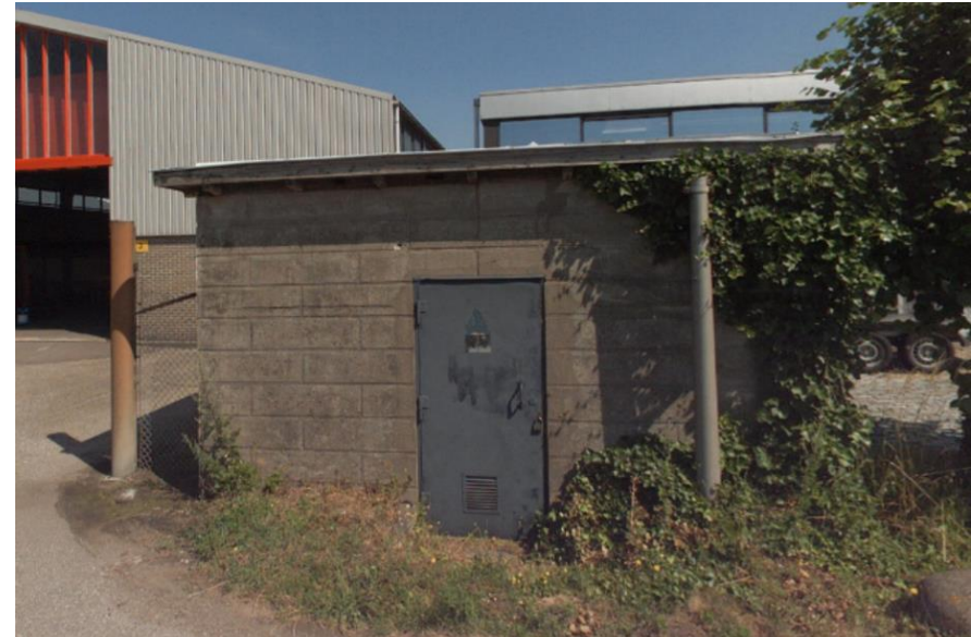
Gepleisterd transformatorhuisje langs de Gouderaksedijk. Foto Gemeente Gouda
