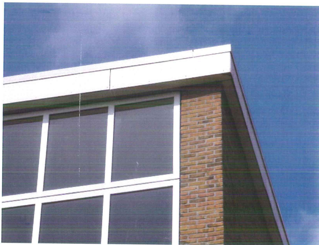
Detail dakconstructie flat Wiardi Beckmanstraat mogelijk verblijfplaats vleermuizen.
