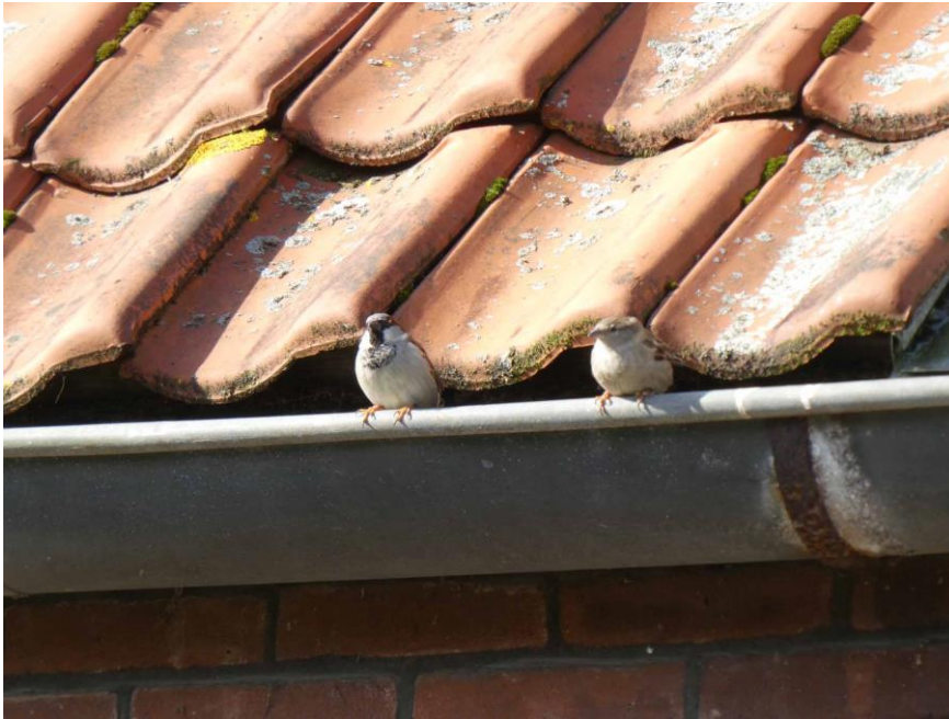
Figuur 11 Koppel huismussen in dakgoot woning overzijde Beatrixlaan
