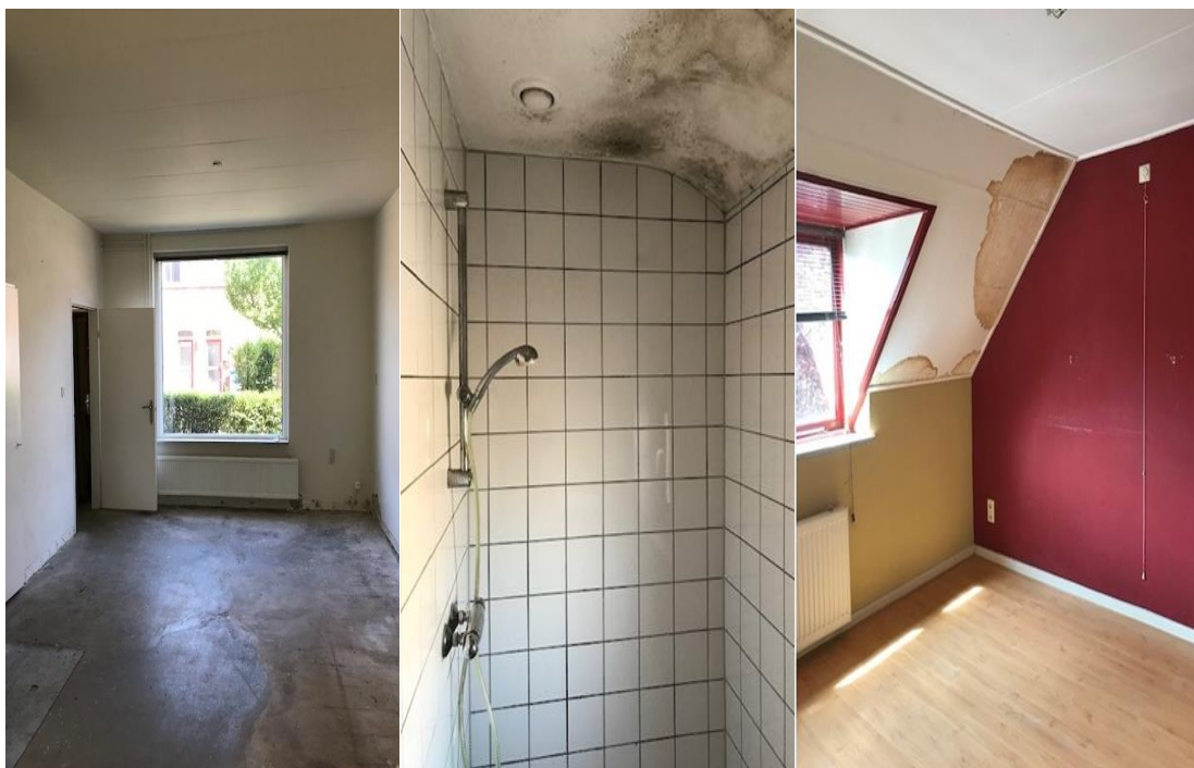
Figuur 9: Foto-impressie van de mankementen in de woningen binnen het plangebied. Van links naar rechts: voel schade door vocht (intern vastgesteld dat ook de vloerconstructie is aangetast door vocht), schimmel in de badkamer vanwege slechte ventilatie en vochtschaden aan het dak. Foto: Poort6
