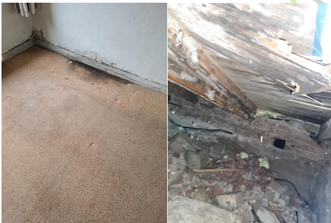
Figuur 10 aangetaste vloeren in de woningen van complex 504 en 515
