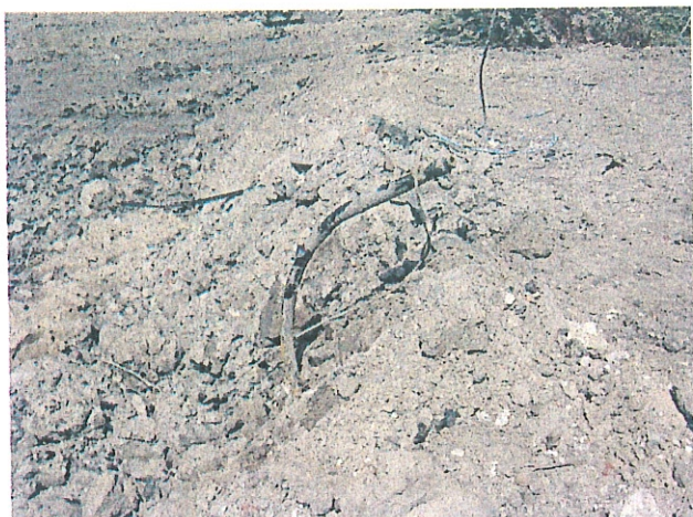
Foto 1: overzichtsfoto met leiding waar verontreiniging zichtbaar is aangetroffen tijdens werkzaamheden
