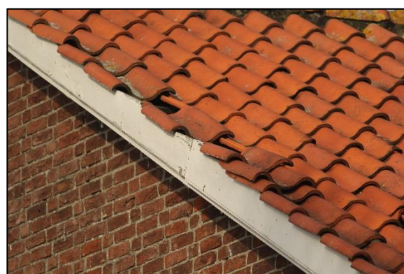
Foto 6: Losliggende dakpannen van Zomerendaan
