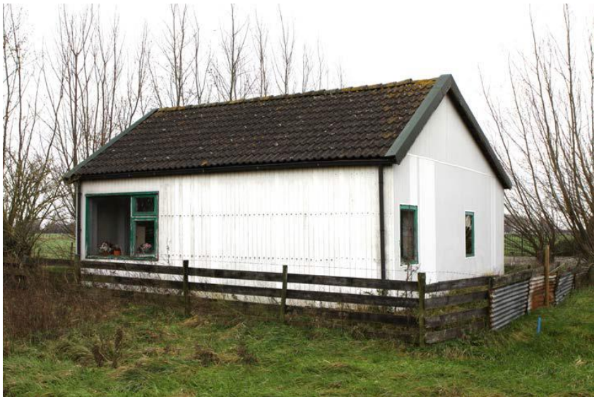
Afbeelding 10: Te slopen vervallen woning
