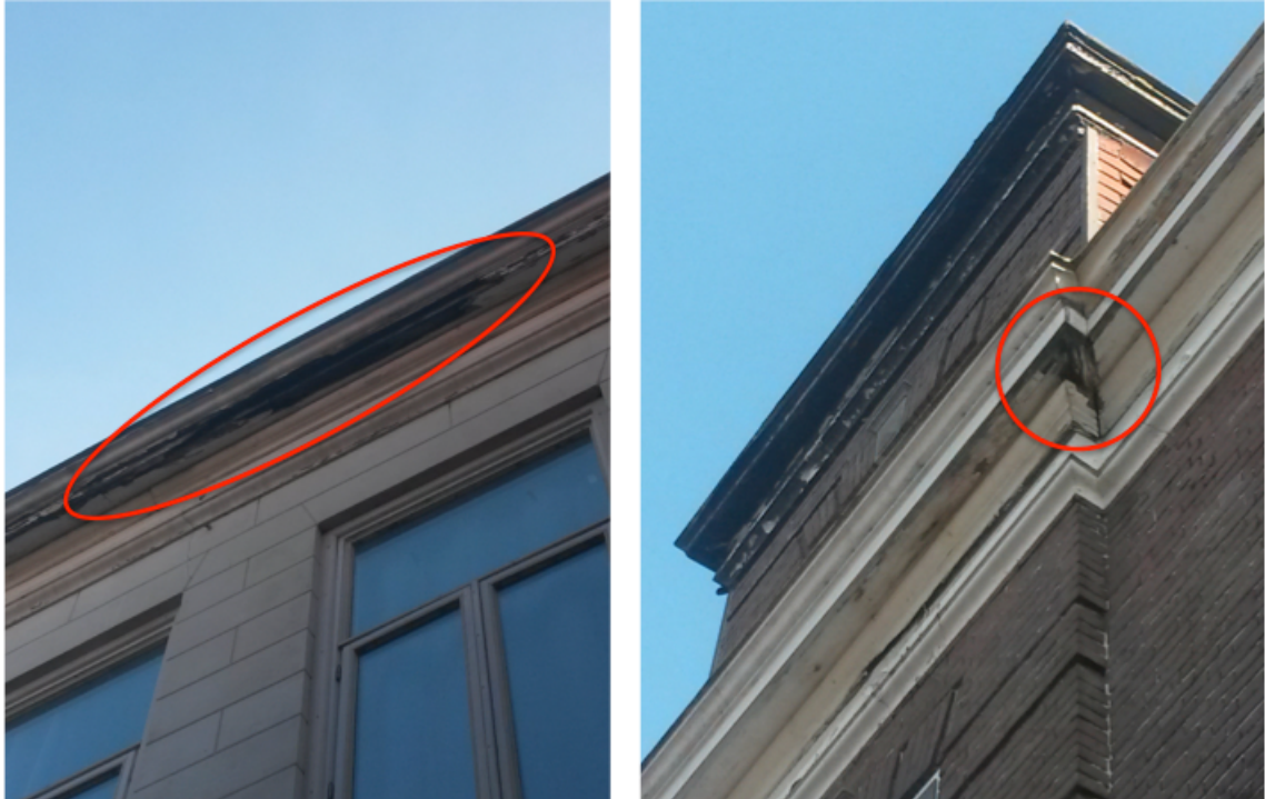
Figuur 3 Waargenomen spleten/scheuren (rood omcirkeld) in houten daklijst
