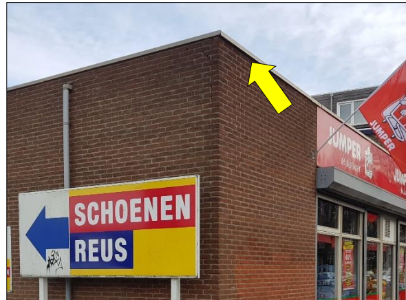
Figuur 14. Kierende dakrand in de Jumper
