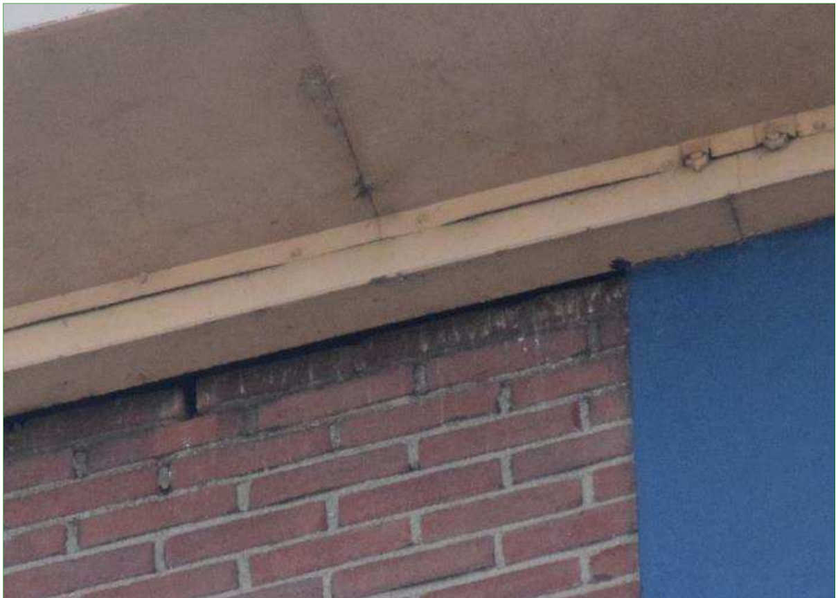
Spleet tussen dakrand en buitengevel en resten van mogelijk vogel uitwerpselen.
