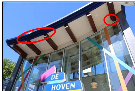
Afbeelding 4: Openingen bij overstek; houten balken en dakrand
