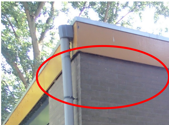
e) kier onder dakrand nr 12.
