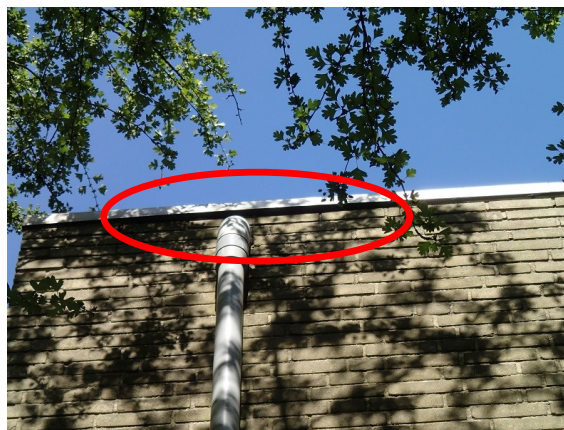
f) kier onder dakrand nr 14.
