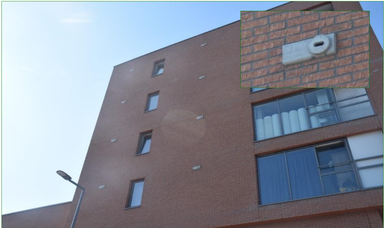
Voorbeeld van toepassing van inbouw Gierzwaluwnestkasten op een buitengevel van een appartementencomplex (foto's F. van der Knaap).
